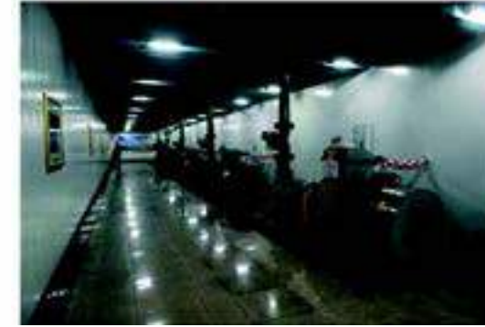
山西大同煤矿泵使用现场 (型号: MD450-60×6 数量: 10台) Shanxi Datong Mine Coal pump working site (Model: MD450-60×6, 10 sets)
